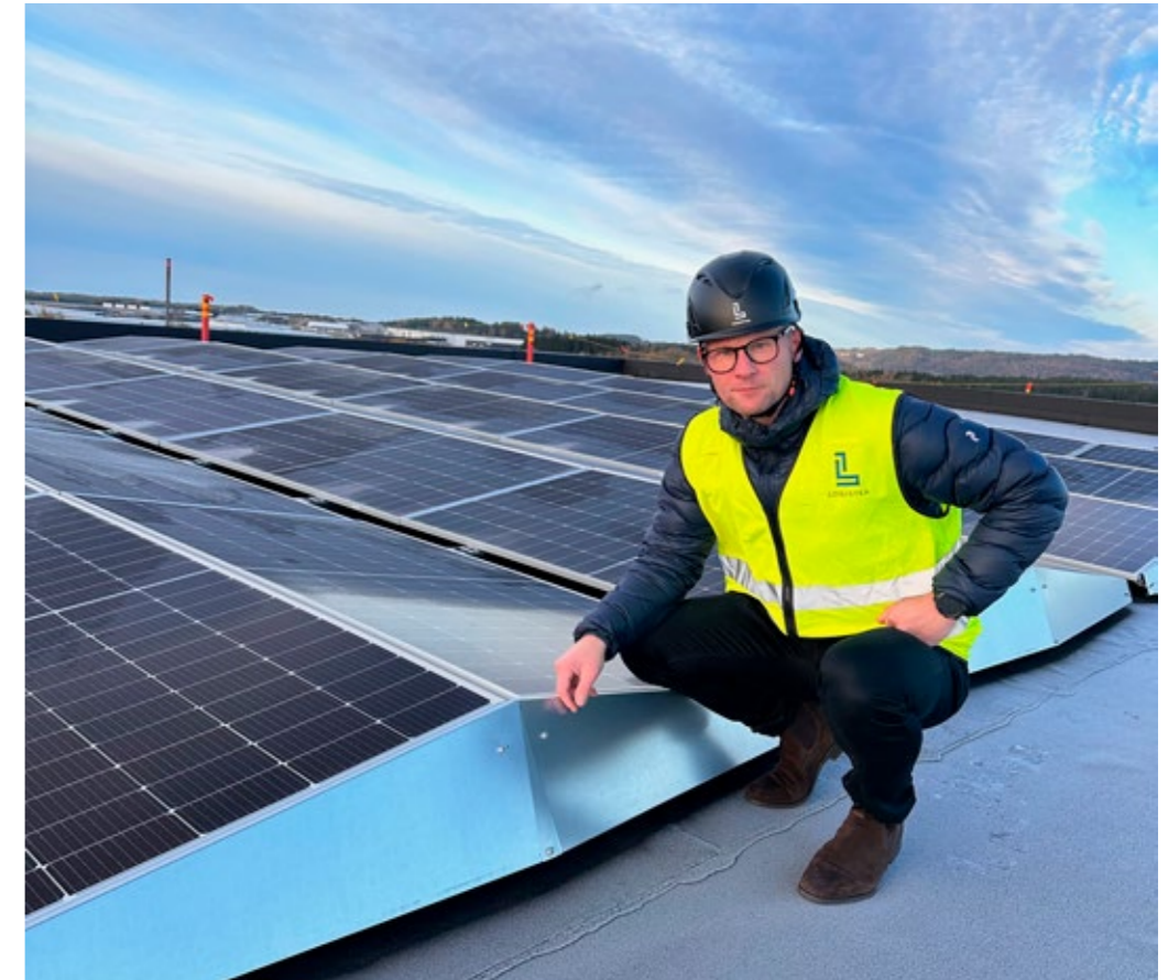
Färdigställda solceller med 495 kWp → på fastigheten Borås Vindan 1.
